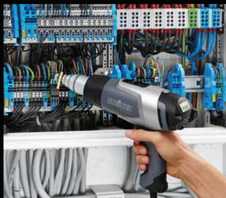
Kabel schrumpfen im Verteilerschrank.
